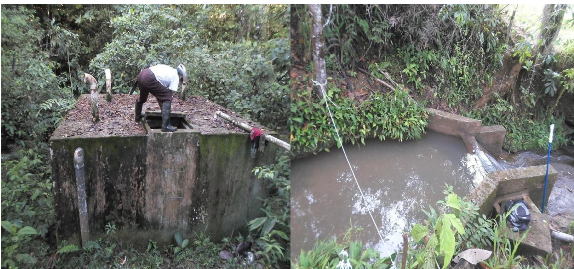
Figura 13. Tanque de almacenamiento y bocatoma de la vereda Los Andes. Fuente: este trabajo.
