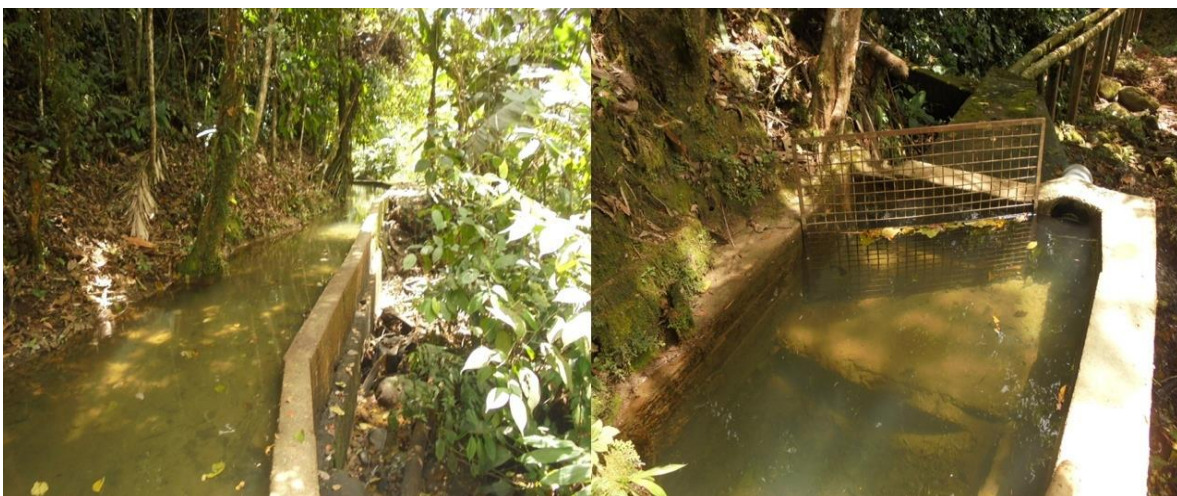
Figura 7. Canal de ingreso a la bocatoma y rejillas artesanales. Fuente: este trabajo.
