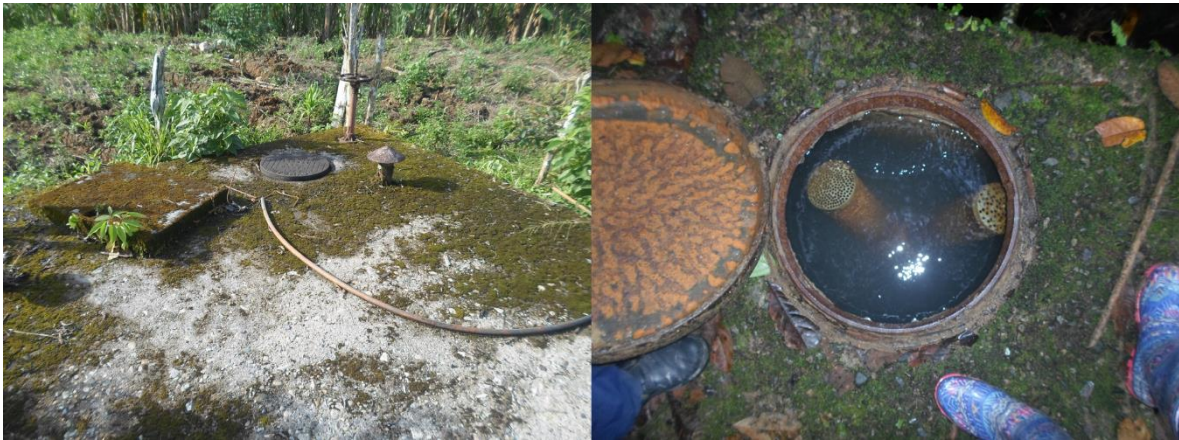
Figura 4. Tanque de almacenamiento y cámara de recolección. Fuente: este trabajo.
