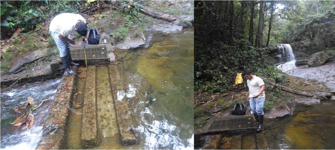
Figura 2. Rejillas de cribado grueso de la bocatoma de Caliyaco. Fuente: este trabajo.
