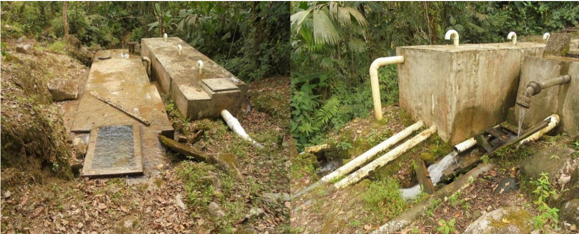
Figura 8. Desarenador y tanque de almacenamiento. Fuente: este trabajo.
