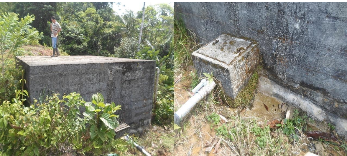
Figura 3. Tanque de almacenamiento. Fuente: este trabajo.
