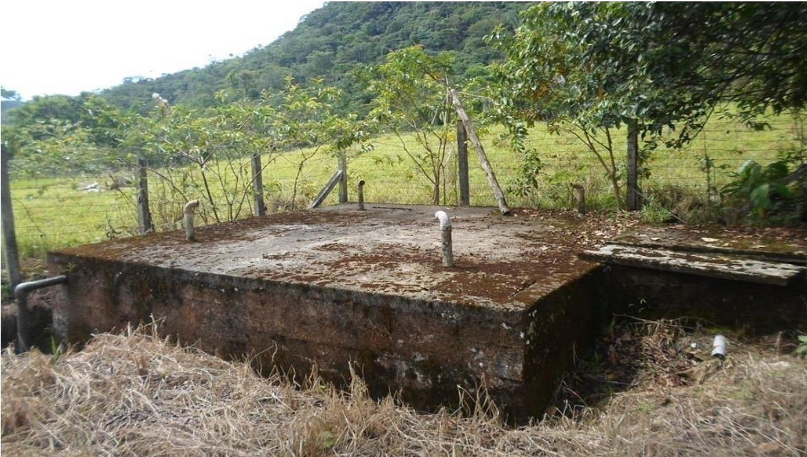
Figura 11. Tanque de almacenamiento. Fuente: este trabajo
